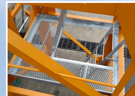
플랫폼 및 핸드레일류 용융아연도금 적용에 의한 내구성, 내식성 증대
