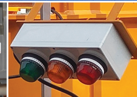
신호램프를 통한 운전 상태 시각화로 무선원격조정 안전성 증대
